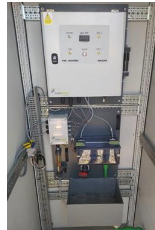
Una foto dello strumento installato
