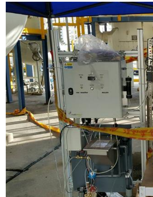
Foto che mostra l'MS1200 nell'impianto petrolchimico.
