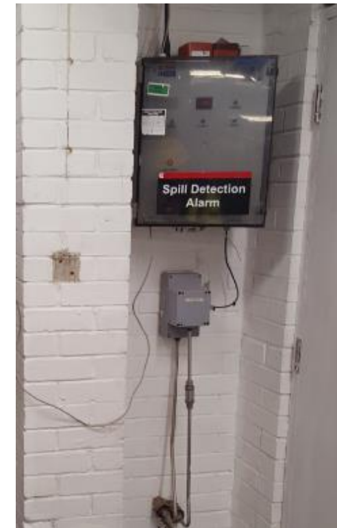
Foto dell'unità installata nella fabbrica del produttore.
