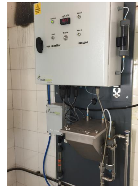
Una foto dell'unità installata in un locale tecnico all'esterno del pozzo.
